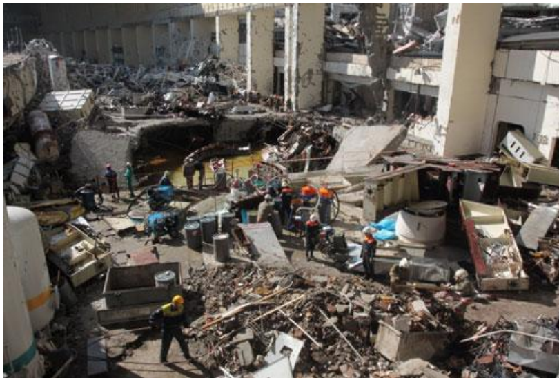
Рис. 2 – Машинный зал СШГЭС после аварии (фото Александра Черных)
