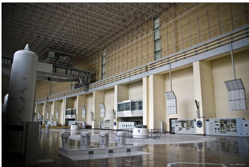
Рис. 1 – Машинный зал СШГЭС до аварии (фото http://bigpicture.ru/?p=4962 )
